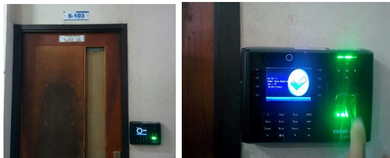
Gambar 4. Instalasi door lock berbasis RFID
