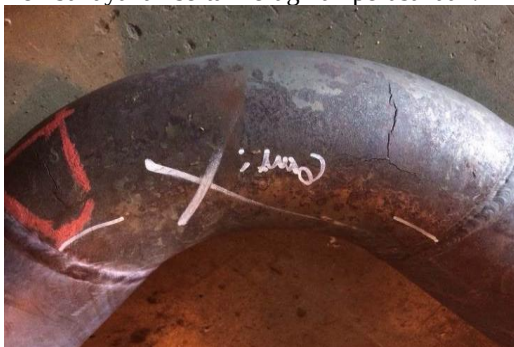
Gambar 1 Crack pada elbow 90°
